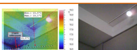
Rilievi termografici per verifica infiltrazioni da copertura capannone industriale Dicembre 2019
